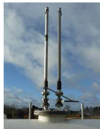
Figur 3. Säkerhetsventiler med avblåsningsrör på gasolcistern. Foto: MSB
