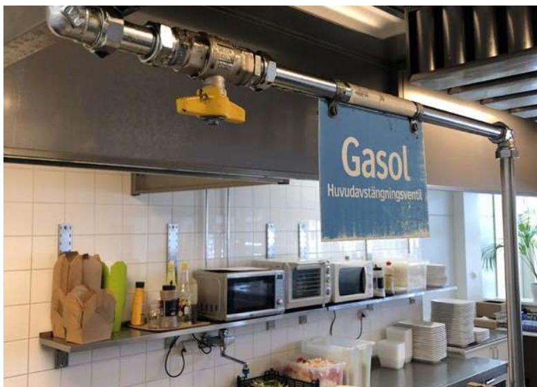
Figur 6. Huvudavstängningsventil i restaurangkök. Foto: David Gårsjö.
