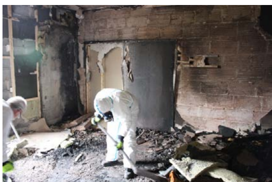
Exempel på helt utbränt startutrymme i flyktingförläggning. Foto: MSB
