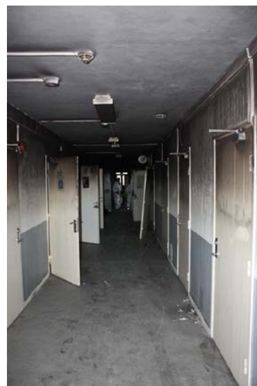
Exempel på kraftiga rökskador i flyktingboende. Foto: MSB
