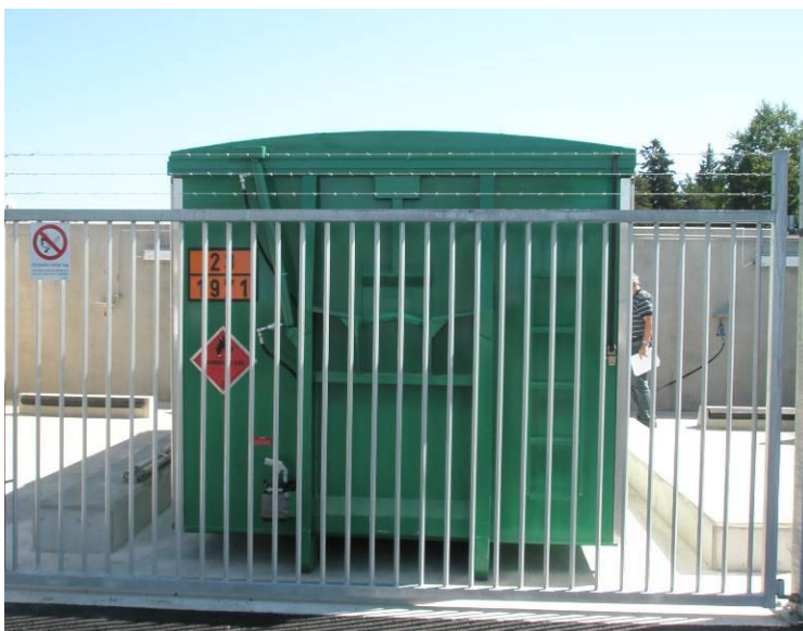
Mobilt gaslager, även kallat gasflak eller MEG-container.
