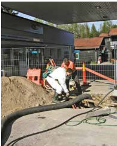
Återkommande kontroll av cisterner i mark
