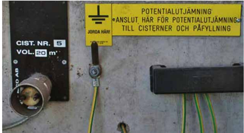
Anslutning för potentialutjämning mellan fordon och cisterner
