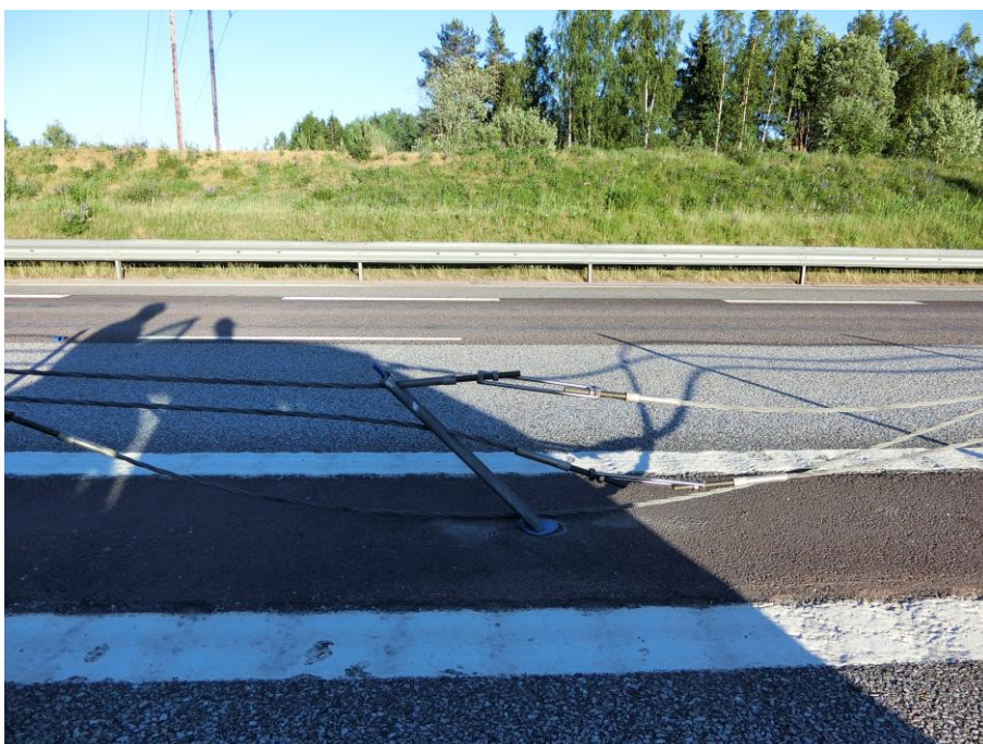
Figur 5 Stolpe deformerad av vantskruv.
