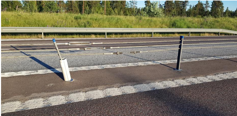
Figur 1 Stolpe deformerad av vantskruv.
