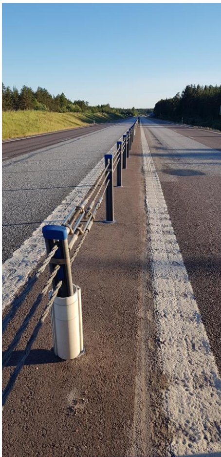
Figur 2 Stolpe deformerad av vantskruv.
