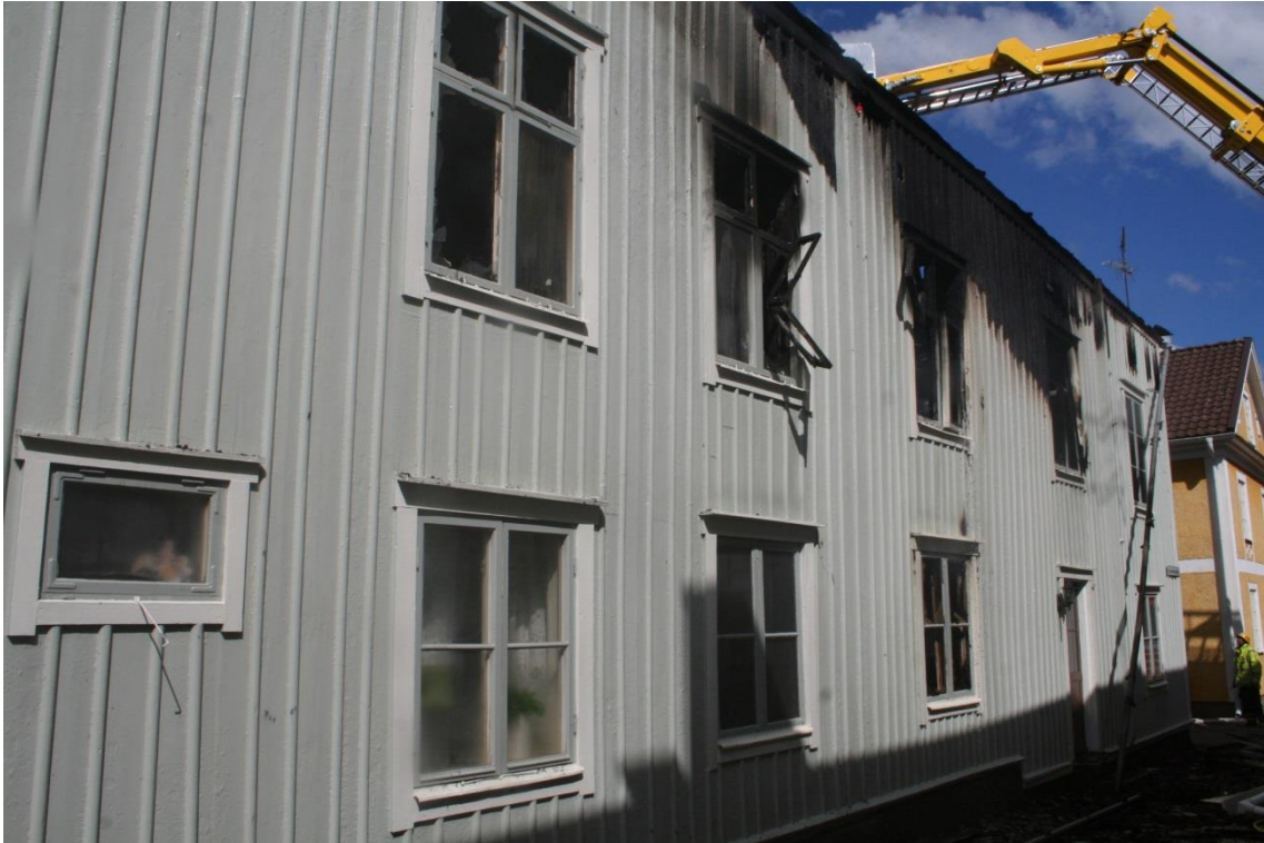
Bild 15 Fasad mot Vaxblekaregränd, igenslaget sovrumsfönster längst t.v., nästa två fönster vardagsrum och två närmaste allrum (andra våning).
