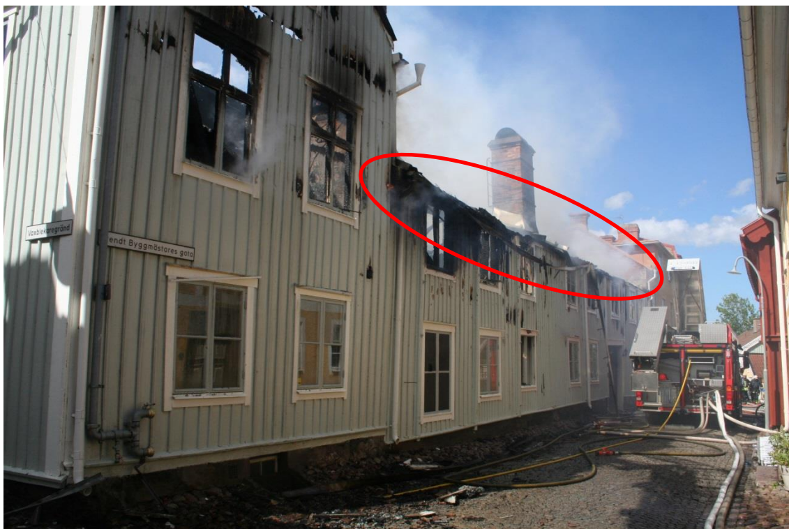
Bild 6 Snabb spridning av branden på den låga vinden
