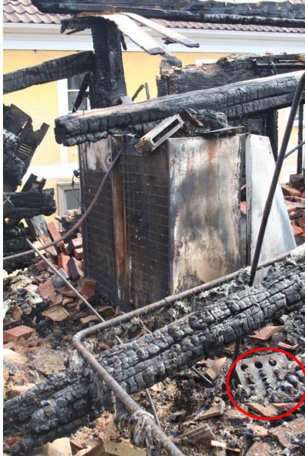
Bild 18 Kyl och frys. Vägg som stod bakom har brunnit ner, ring visar proppskåp som undersöktes
