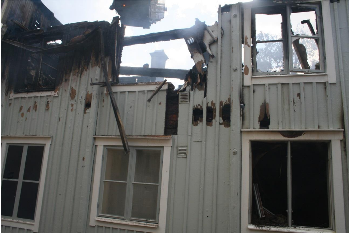
Bild 13 De utbrända fönstren på tvåvåningsdelen, de två fönster som satt i köksdel t.v., samt fönster i sovrums.
