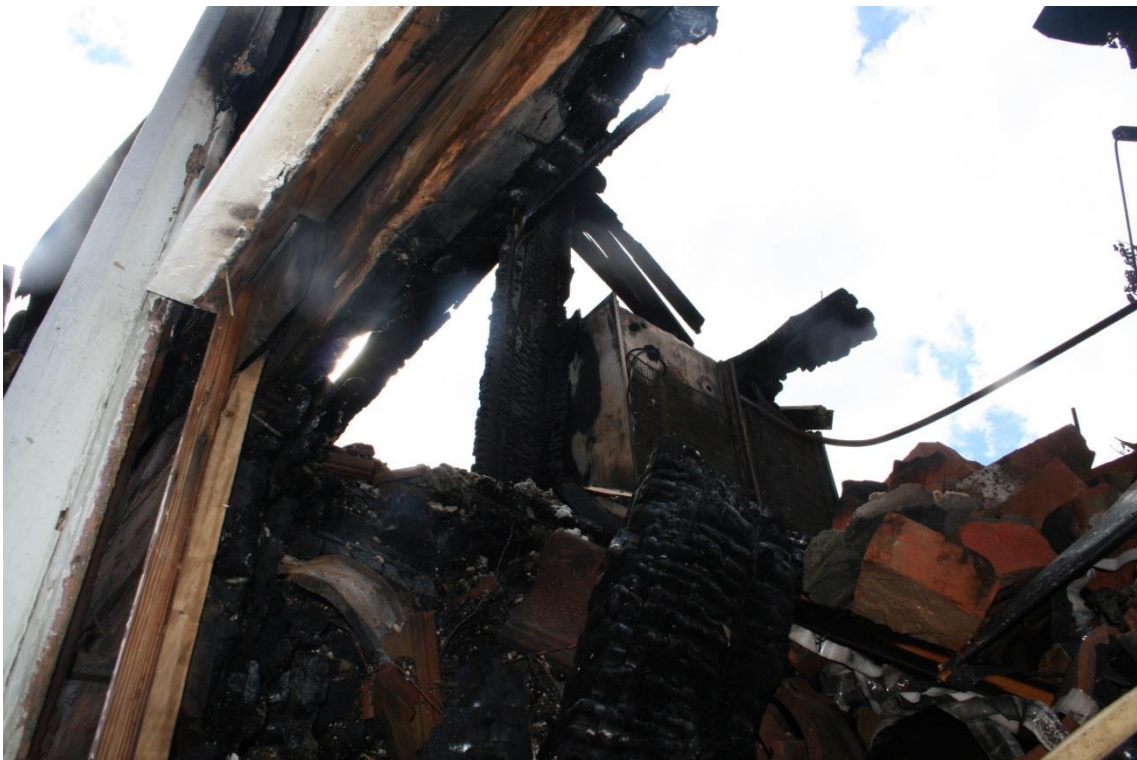
Bild 14 Foto taget från under sovrums, bjälklaget har helt rasat ner
