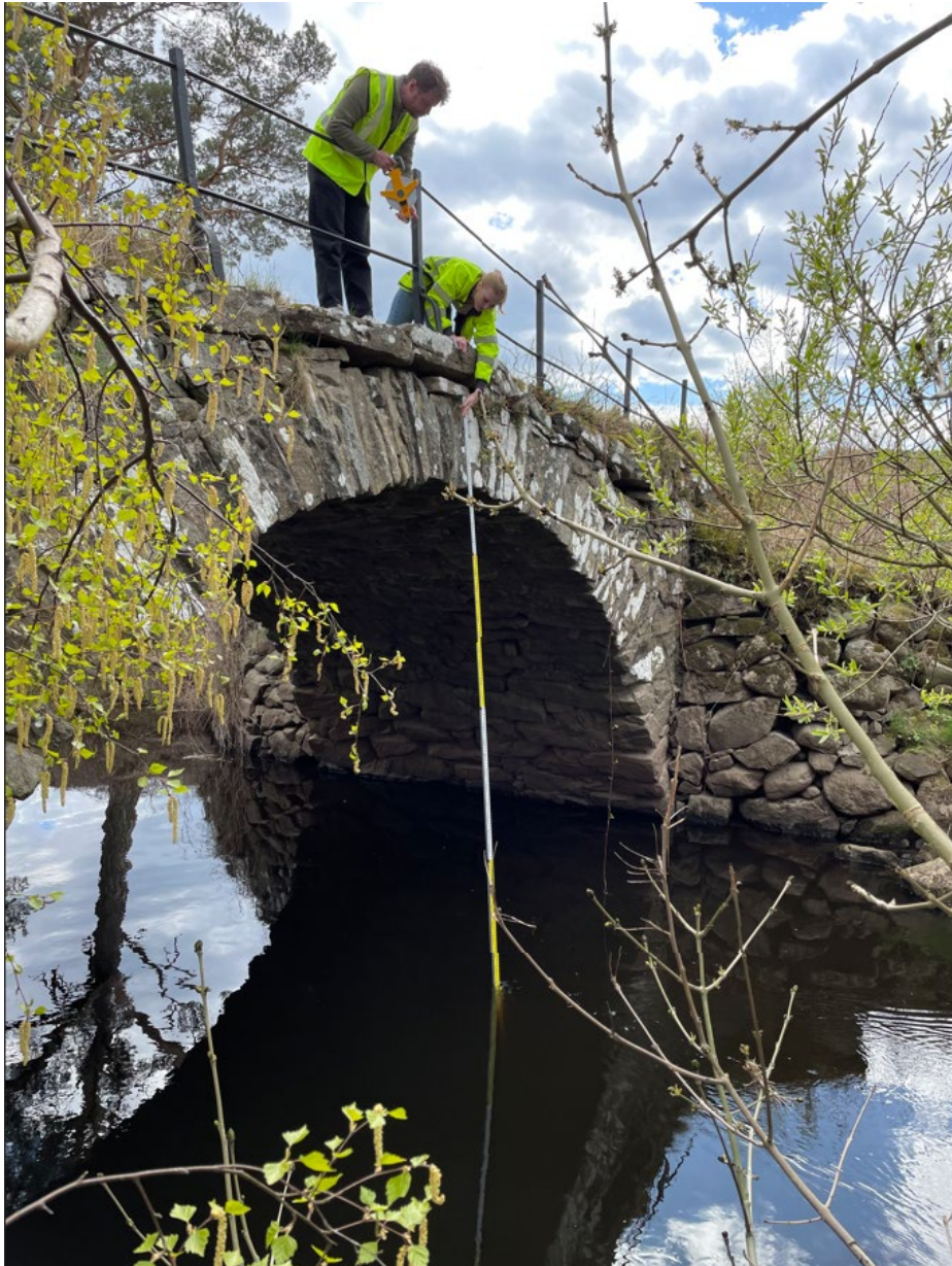
Figur 1. Manuell inmätning av äldre bro i samband med platsbesök den 4 maj 2023. Bron ligger i Suseån vid Broen (ca 3,8 km nedströms Berte kvarn). Ritningar saknas på bron.
