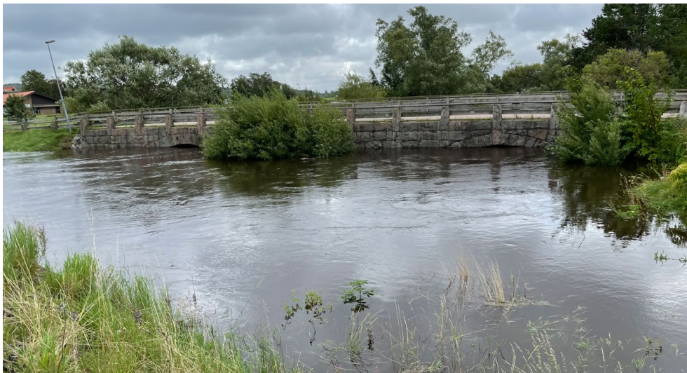
Figur 3. Foto av stenvalsbron i Getinge tagen i samband med inmätningen under ovädret Hans, den 10 augusti 2023.
