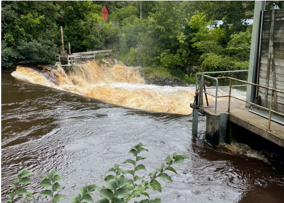
Figur 4. Dammen vid Broberg under ovädret Hans, den 10 augusti 2023.
